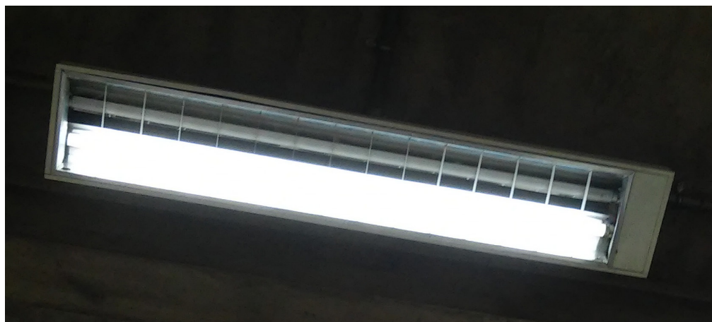
Figura 63 - Algumas luminárias instaladas no espaço mostrado na imagem à esquerda, estão com lâmpadas queimadas. As lâmpadas instaladas são fluorescentes tubulares T8 e T10. Fonte: autora.
