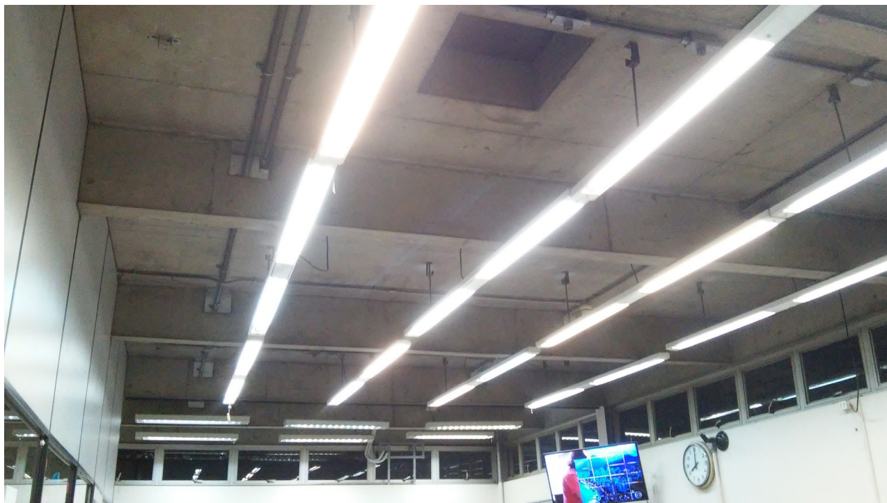
Figura 60 - Luminárias instaladas no espaço onde trabalham os teleoperadores. É possível perceber a falta de uniformidade na temperatura de cor das lâmpadas. Fonte: autora.
